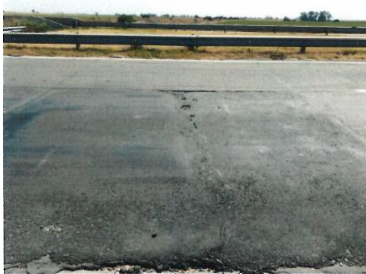
FOTO 3. ESCALONAMIENTO Y FISURA TRANSVERSAL
