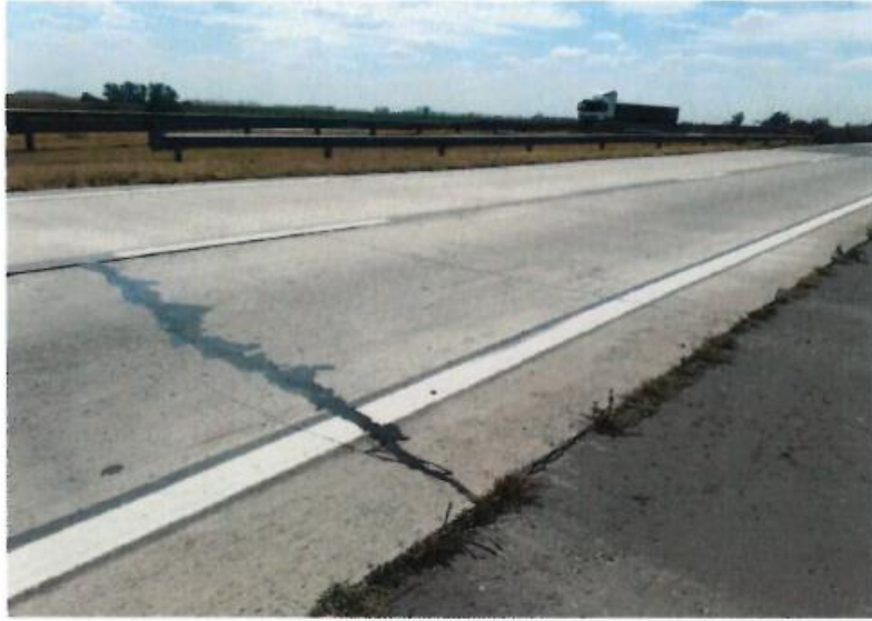
FOTO 2. ESCALONAMIENTO Y FISURA TRANSVERSAL
